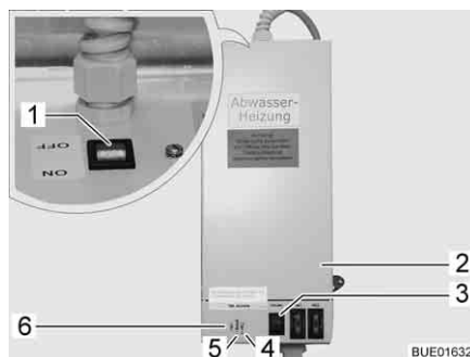
Afb. 217 Transformator met regelapparaat
