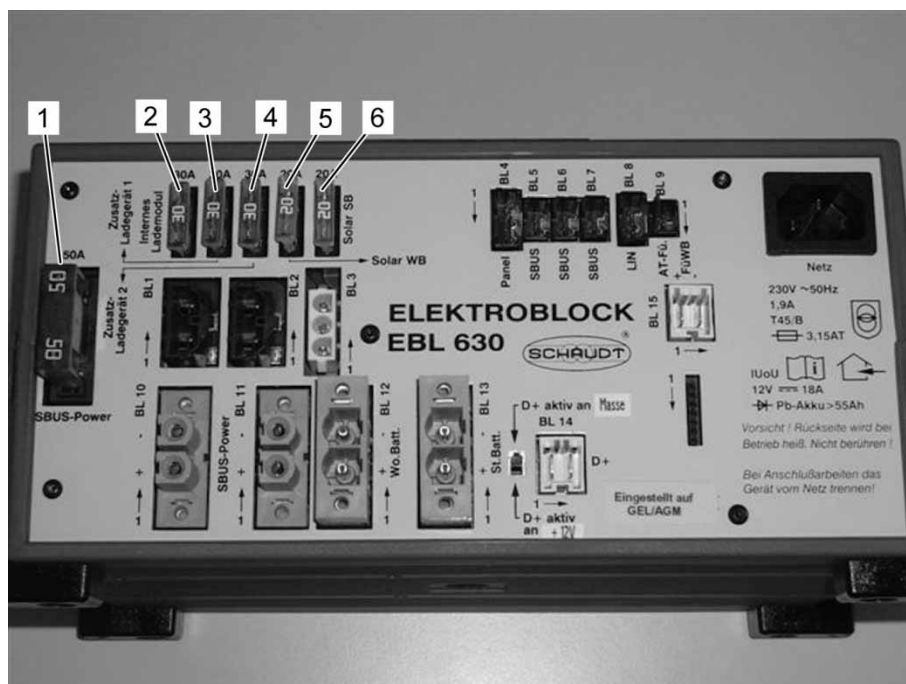
Afb. 4: Plaatsing van de slots voor de zekeringen bij EBL 630
