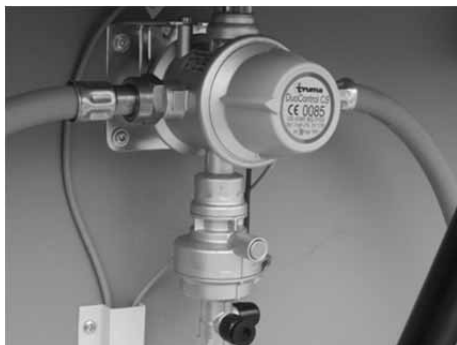
Afb. 80: Gasinstallatie (met Eis-Ex en display op afstand)
